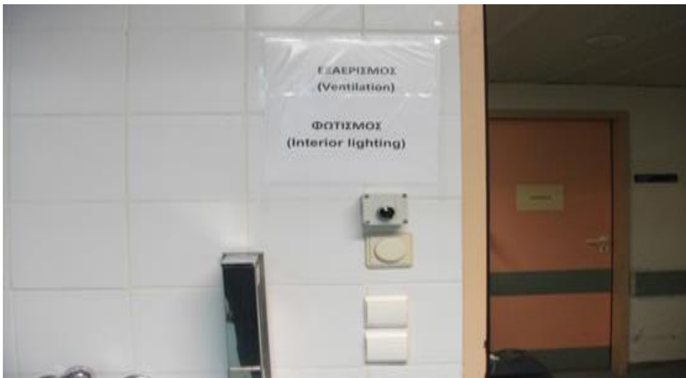
Εικόνα 19. Προειδοποιητικές πινακίδες φωτισμού και εξαερισμού
