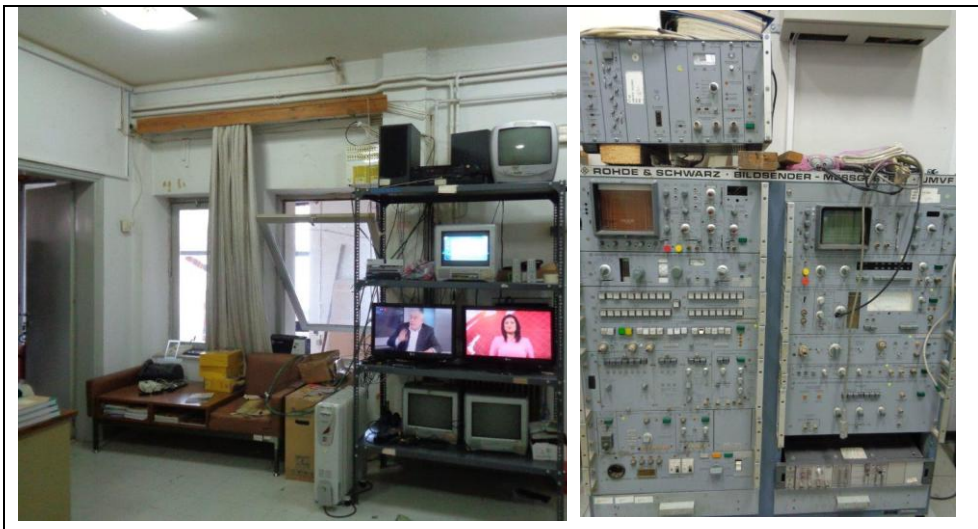
Σχήμα 21. Το κέντρο εκπομπής της ΕΡΤ στον Υμητό.
