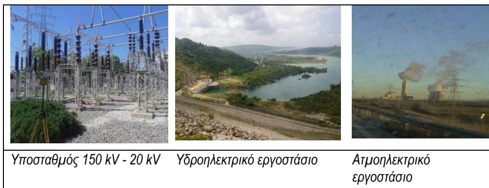
Σχήμα 17. Χώροι μέτρησης σε εγκαταστάσεις της ΔΕΗ. Υποσταθμός υποβιβασμού τάσης ανοικτού τύπου, υδροηλεκτρικό και ατμοηλεκτρικό εργοστάσιο.
